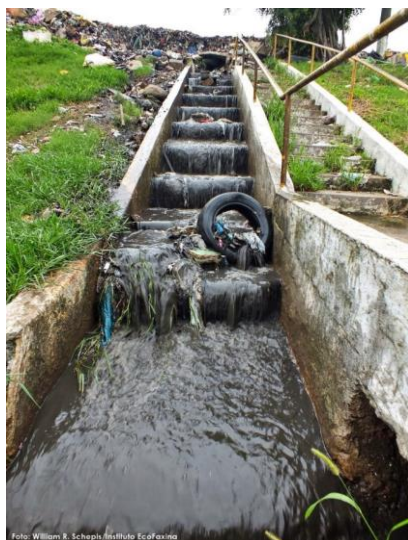
Fig. 28: Talude no Parque Sambaiatuba – chorume e água Fonte: http://www.tribuna.com.br
